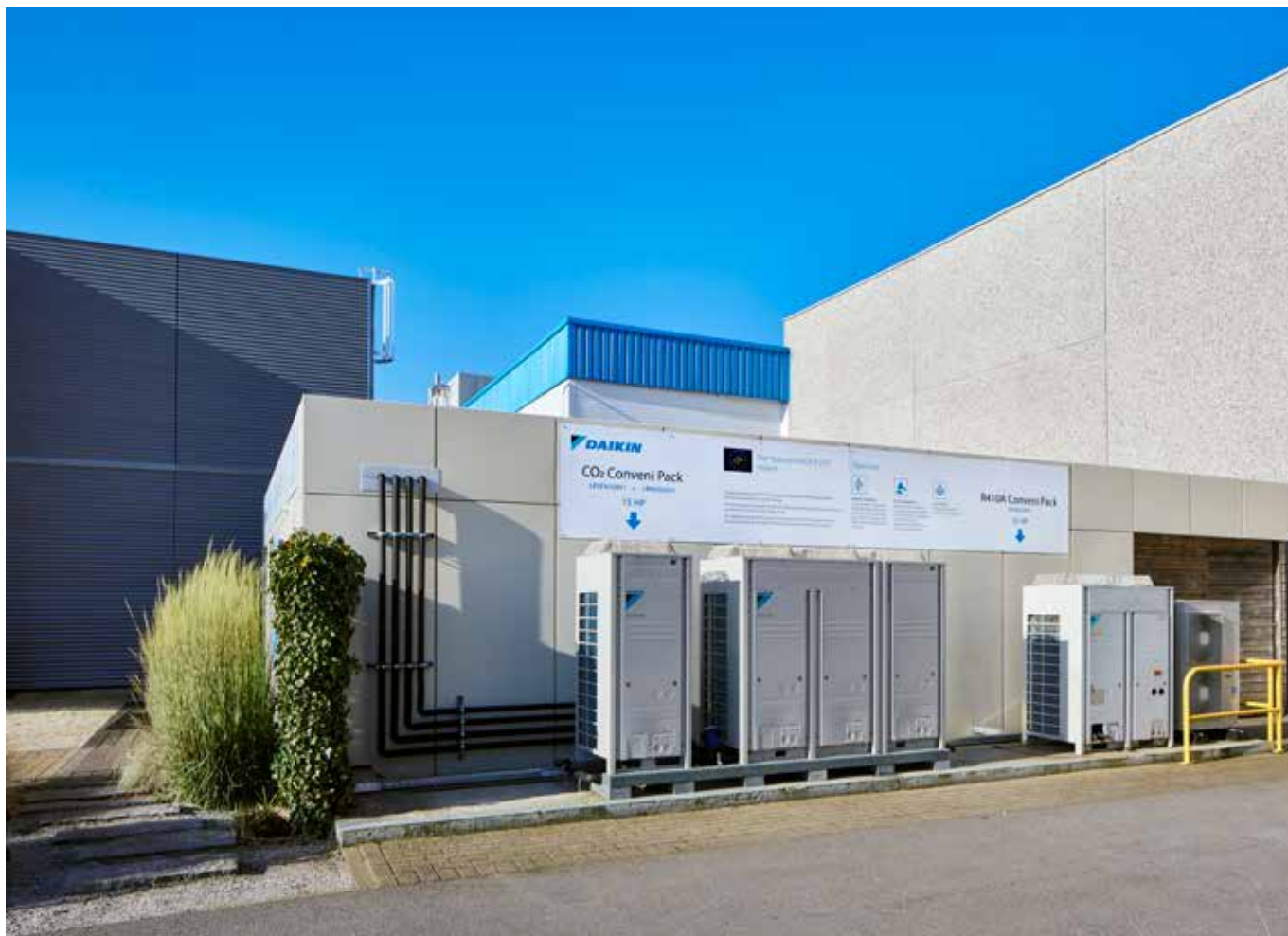
Zdjęcie: Pierwszy prototyp zainstalowany w rzeczywistych warunkach w zakładzie Daikin Europe N.V.
